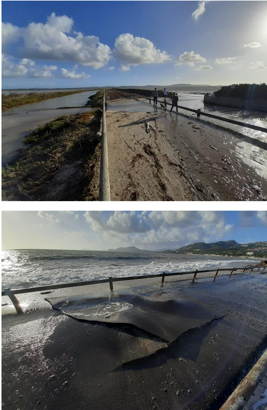
Figure 35 : rupture du cordon dunaire et dégradation de la route du Sel au niveau du tombolo de la Presqu'île de Giens à Hyères le 20/10/2023
