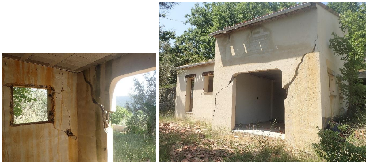
Fissuration affectant la maison coté sud-ouest, Peyrui.
