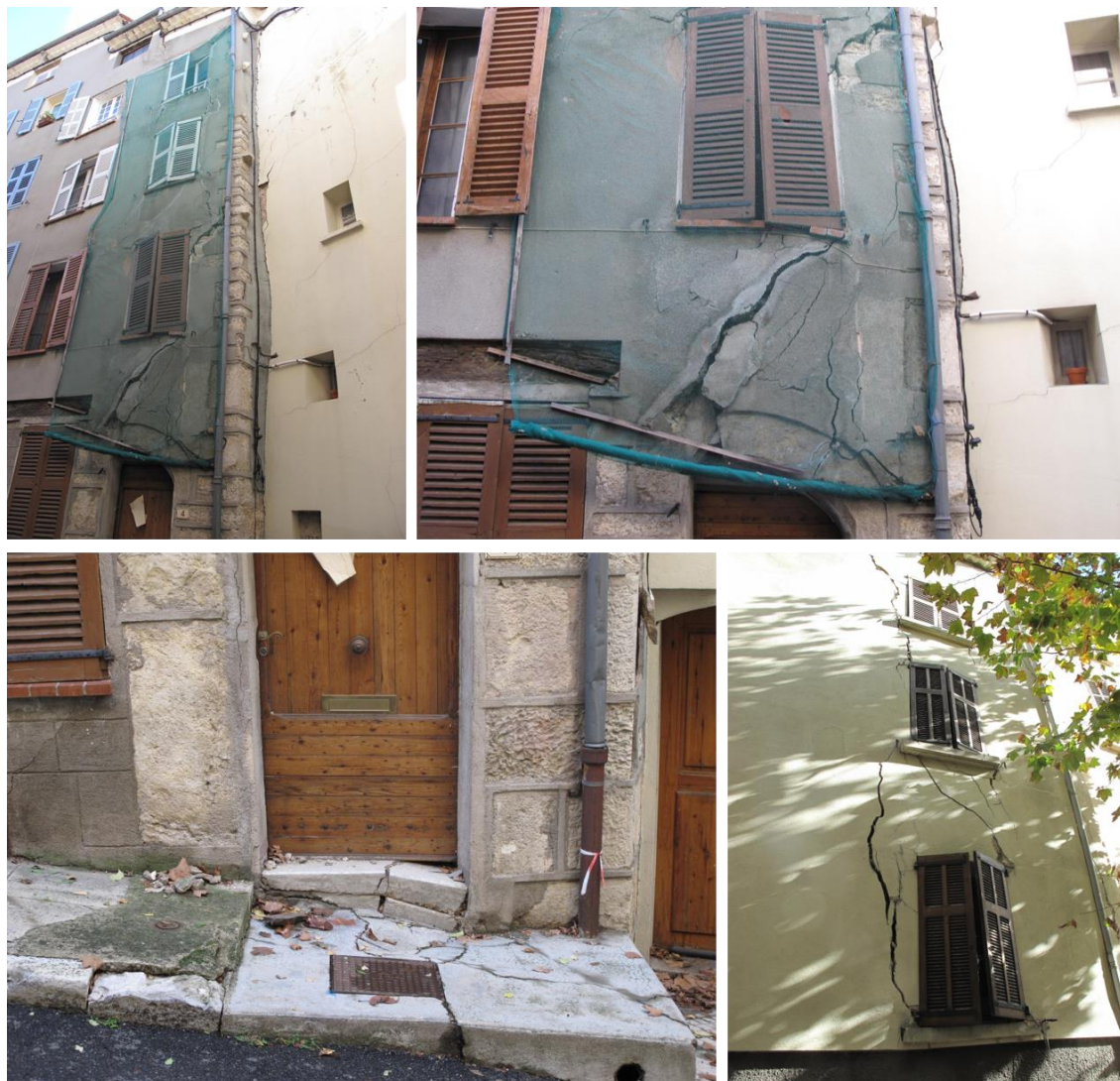
Illustration 12 : Désordres sur les habitations du centre-bourg (Source : rapport BRGM/RP-60536-FR par Rivet et Mathon, 2011).
