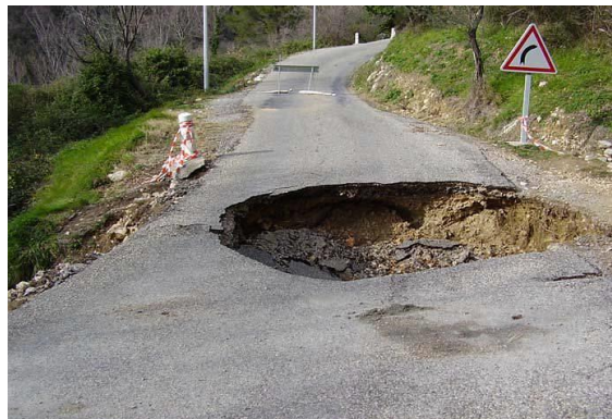
Photo du site de l'effondrement à Seillans de décembre 2006 © BRGM (2002).
