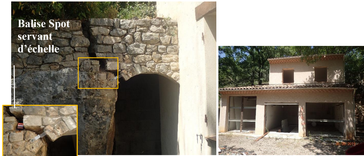
Fissuration ouverte dans le mur en prolongement ouest de la maison endommagée et maison abandonnée restée intacte, Peyrui.
